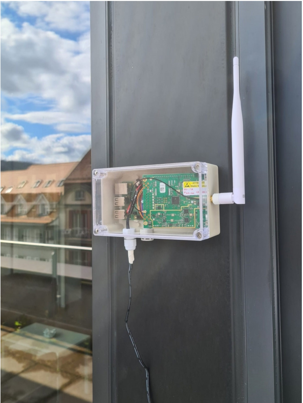
Abbildung 2: LoRaWAN Gateway im wasserdichten Gehäuse auf unserer Dachterrasse
